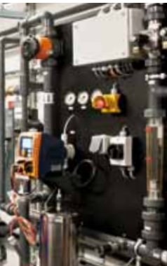
IKS-Verrohrungssysteme, Umwälzpumpen, Wasseraufbereitung
